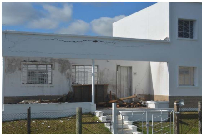
Daños estructurales en viviendas
